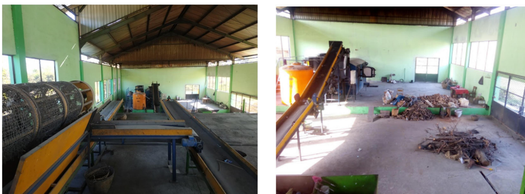
Gambar 4.4. Instalasi pembakaran sampah domestik
